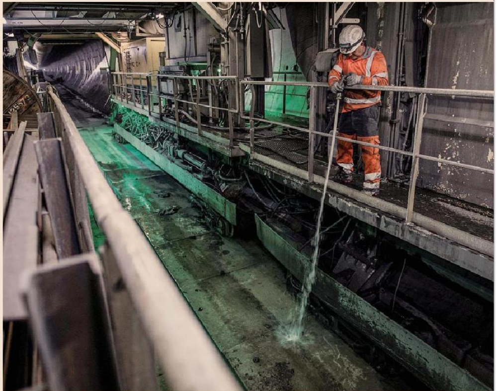
Nel cantiere della Tav. Sono 700 gli operai al lavoro sulla Torino Lione
